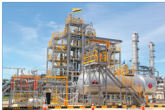
Fig. 1 - Impianto dimostrativo del processo Spera, in Brunei
